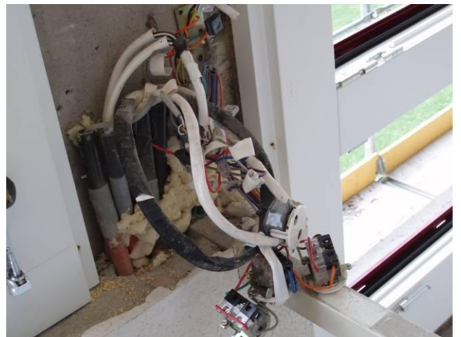
Der Elektriker hat alle Zimmer stromlos gemacht.
