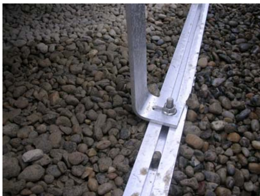
Die Verankerungen der Solar-Panels sind angeschraubt
