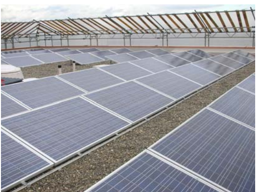
Auf dem Dach stehen 105 Module oder Solar- 3 generatoren zur Stromproduktion bereit
