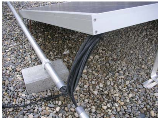
Die Leitungen von den Generatoren leiten den Strom an den Wechselrichter weiter
